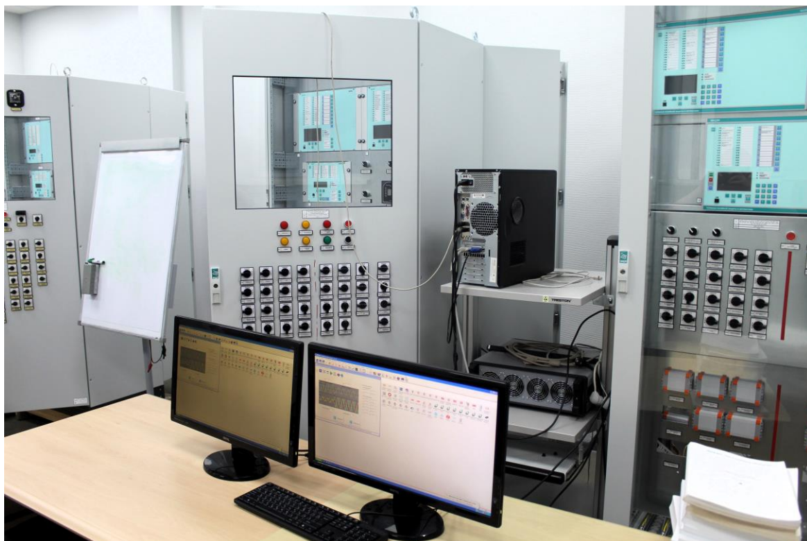
Рис. 9 Лабораторный комплекс на основе шкафа ШЭ2607 152
