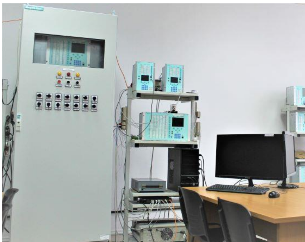
Рис. 13 Лабораторный комплекс устройств управления присоединением
