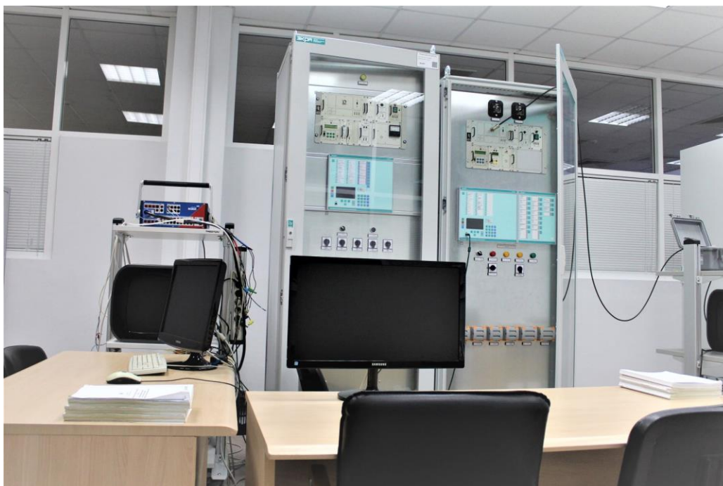
Рис. 4 Лабораторный комплекс на основе шкафа ШЭ2607 488
