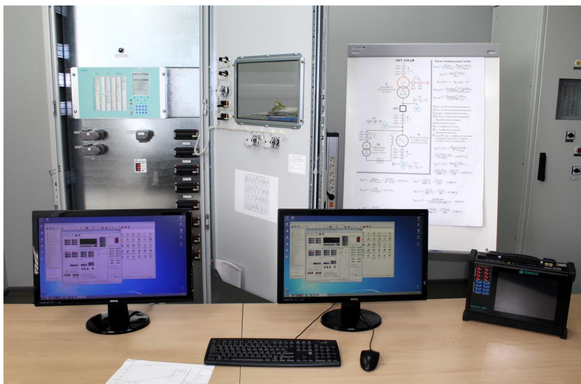
Рис. 10 Лабораторный комплекс на основе шкафа ШЭ1111
